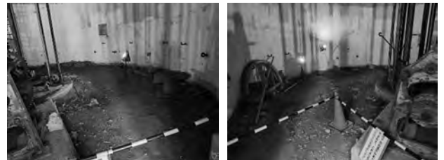
写真-3無線塔内部の巻揚げ機械
