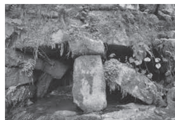
下流側の排水口(右側は石が倒れている)
