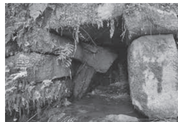
上部写真左側内部(上流から水が流れ出ている)
