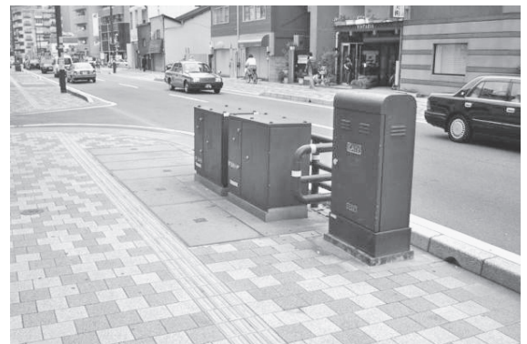
(地上機器設置状況) 地上機器は大部分が電力用です
