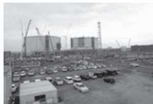
ひびきLNG基地
