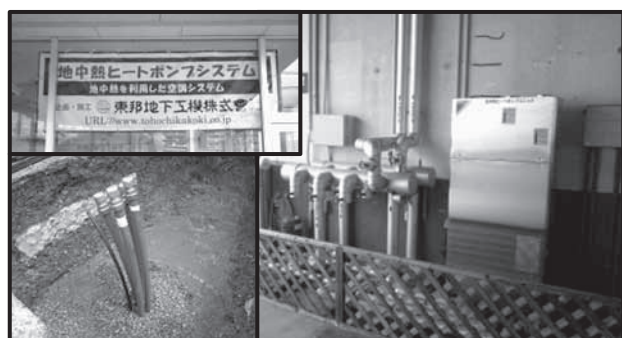
熱交換井とヒートポンプユニット
