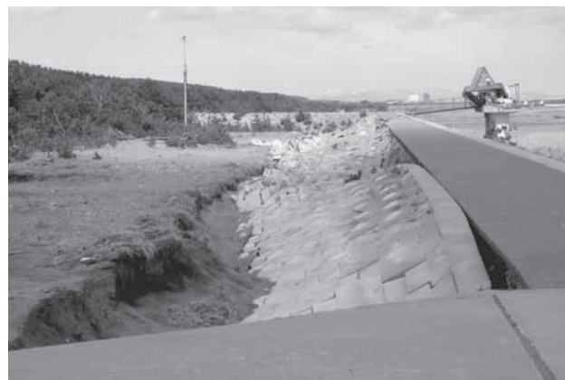
図-1 青森県百石海岸の越波による洗掘
