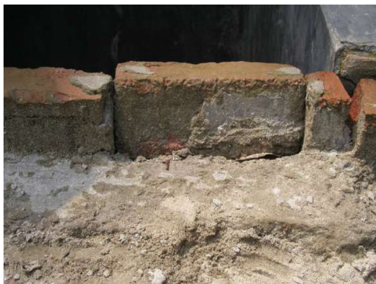
図-4.3.(4) 浄水設備外観（不良箇所拡大）
