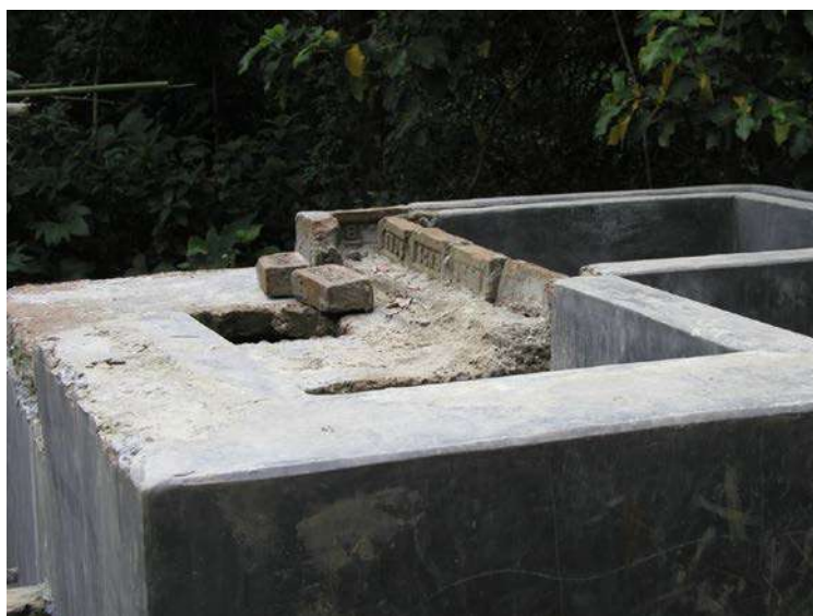
図-4.3.(3) 浄水設備外観（不良箇所）
