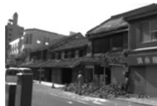
写真2 明治13年築・商家の被害状況
