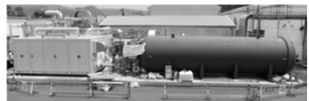
燃料電池1MW級機実証設備外観
