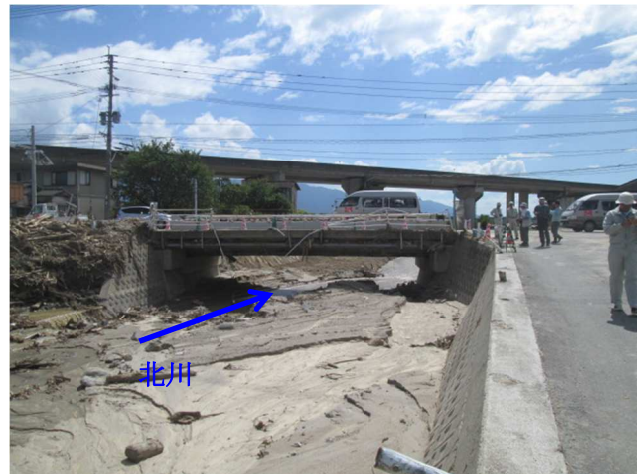
写真 23 災害後の北川氾濫状況
