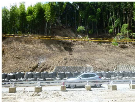
国道 211 号の斜面崩落状況 (TEC-FORCE による道路啓開状況)
