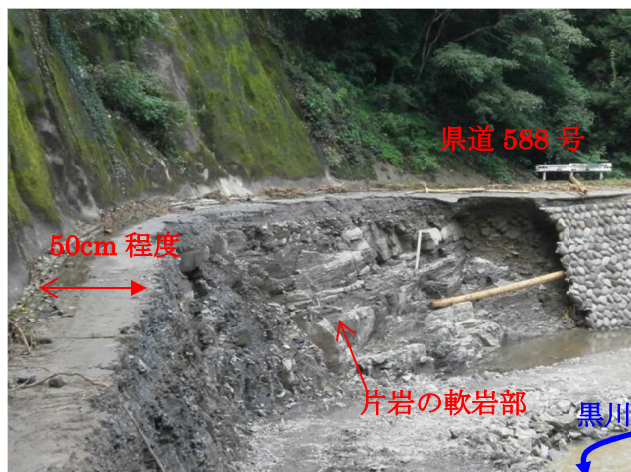
写真1 県道 588 号と黒川右岸側護岸の被災状況
