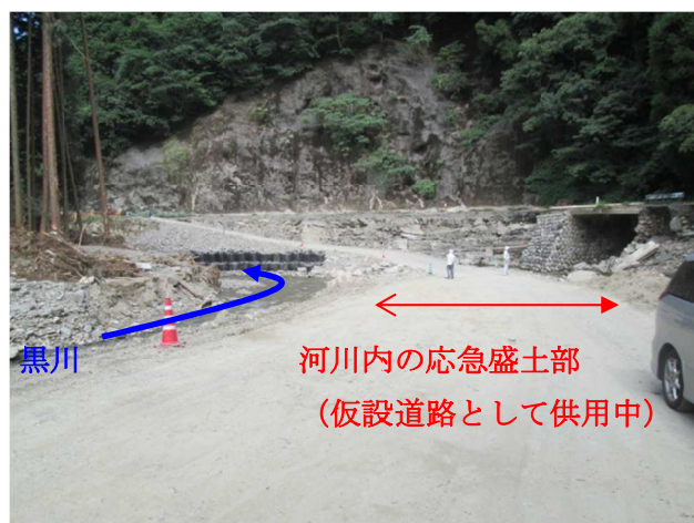
写真2 黒川の上流側からみた下流側の被災状況
