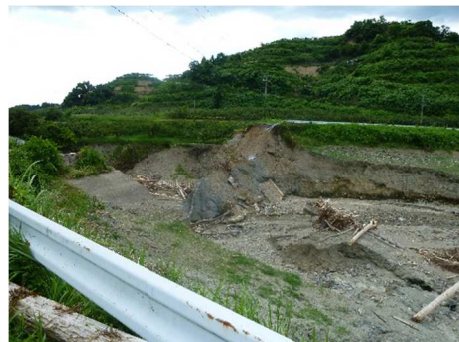
ため池越流堰の決壊 (奈良ヶ谷川のため池)
