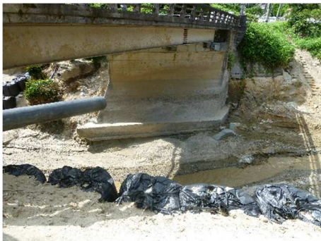
橋台の洗掘状況 (生津橋の橋台)
