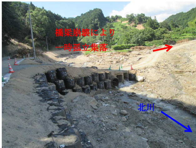
写真 28 災害後の北川護岸状況
