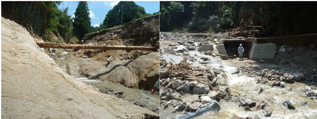
写真 5.6 上流部の護岸流出および流路埋塞の状況
