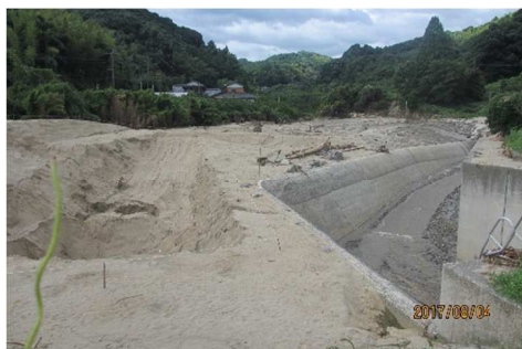
洪水吐とため池内の堆積土砂の状況
