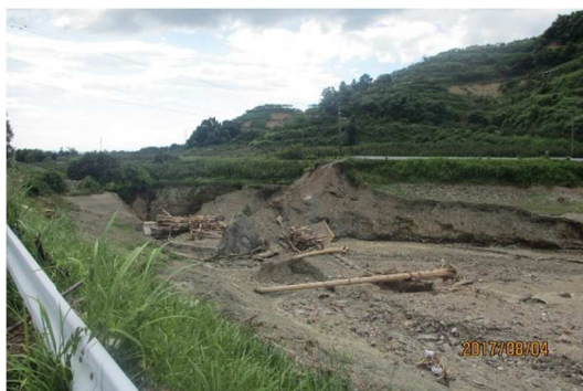
堤体の被災状況(上流部から撮影)
