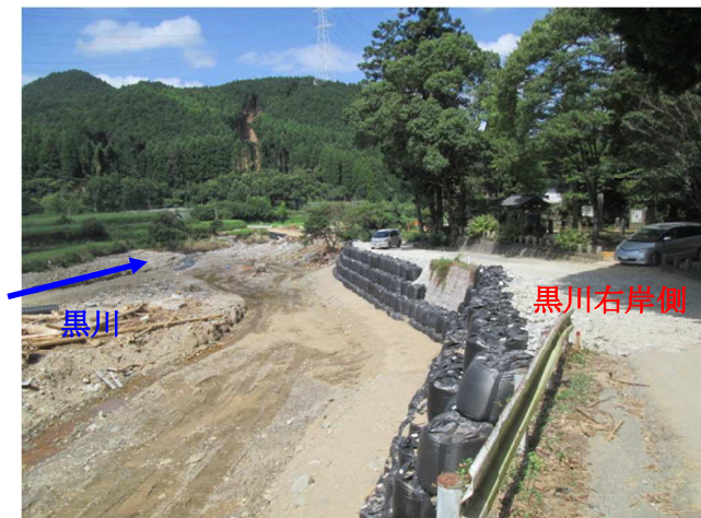
写真5 黒川の護岸崩壊状況
