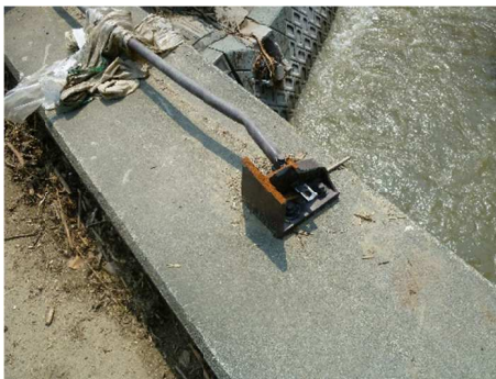
高欄の柱基部が切断 (県道 509 号と 588 号の分岐点の橋)
