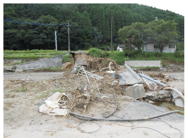
地域コミュニティを分断する橋梁崩落（黒川）
