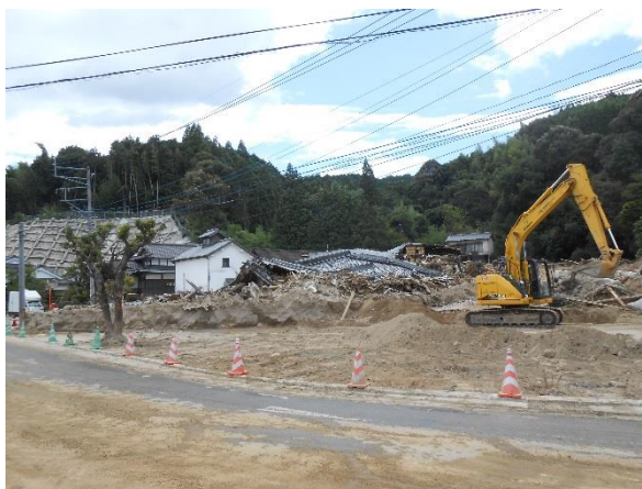
建物が完全に倒壊した集落災害（赤谷川沿い）
