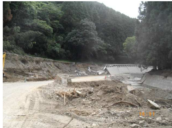
写真-4 県道甘木吉井線崩壊
