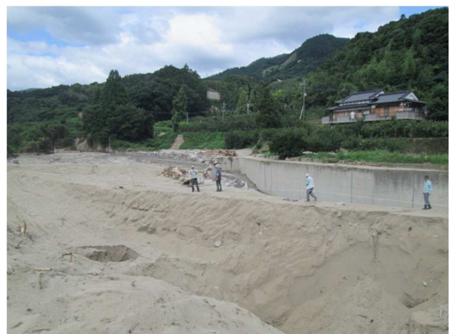
写真 33 災害後の北川土砂堆積状況
