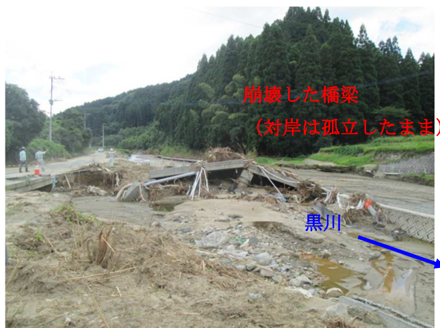
写真4 黒川の濁流による橋梁崩壊状況
