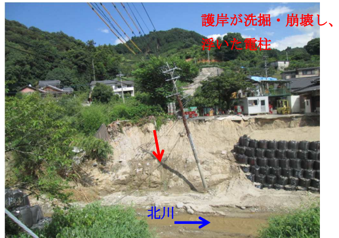
写真 29 災害後の北川護岸状況
