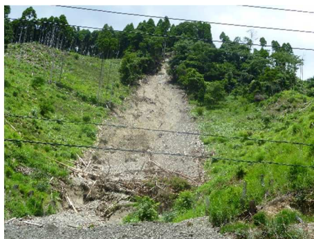
県道 79 号斜面の崩落状況 (大規模の法面の崩落状況)
