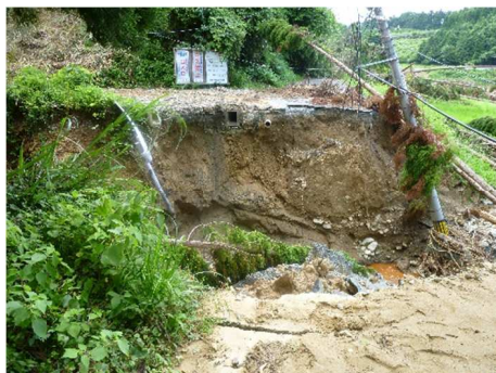
村道の崩落状況 (村道が寸断されている)
