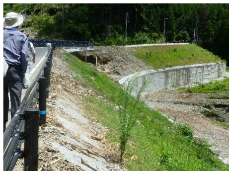
県道 79 号の崩落状況 (盛土斜面の崩落状況)
