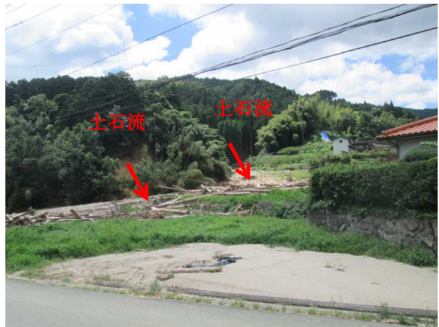
写真13 災害後の赤谷川上流部
