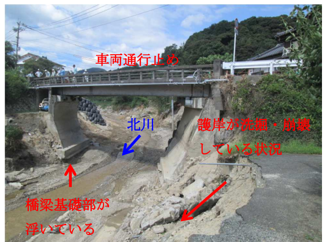
写真 31 災害後の北川被災状況
