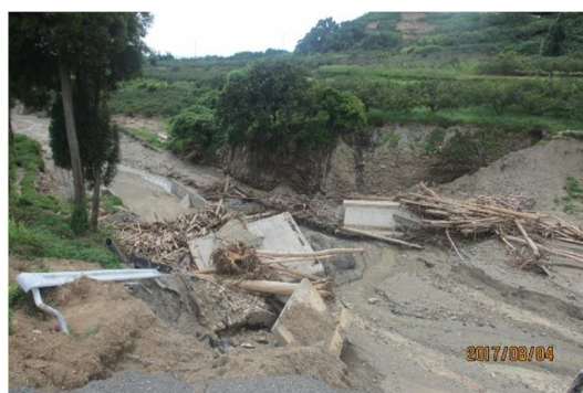
堤体下流部の被災状況
