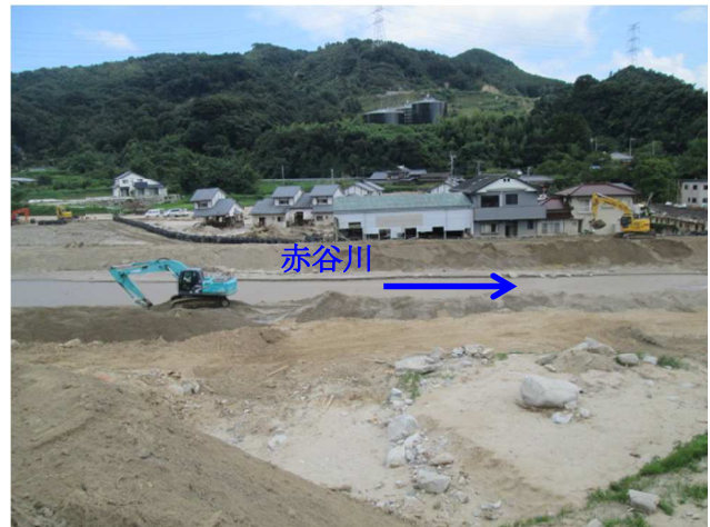
写真 21 災害後の赤谷川氾濫状況
