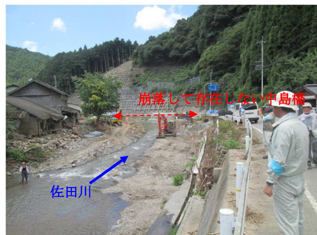
写真8 崩落後の中島橋付近の被災状況
