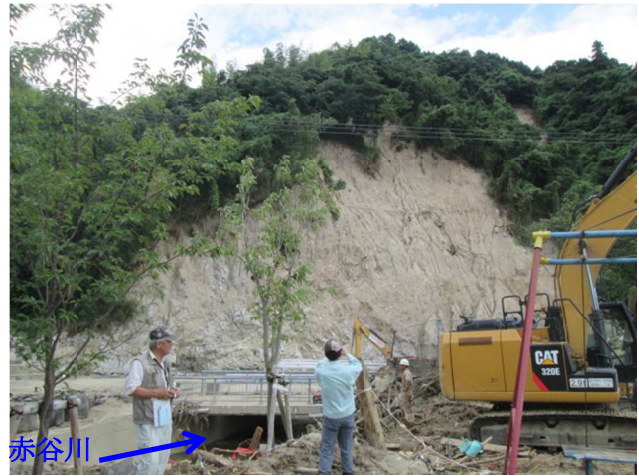
写真 19 松末小学校側の崩壊法面
