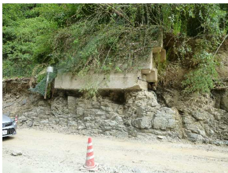
大型ブロック積みの一部（県道 588 号） (他の残骸は反対側の川の中まで流されている)
