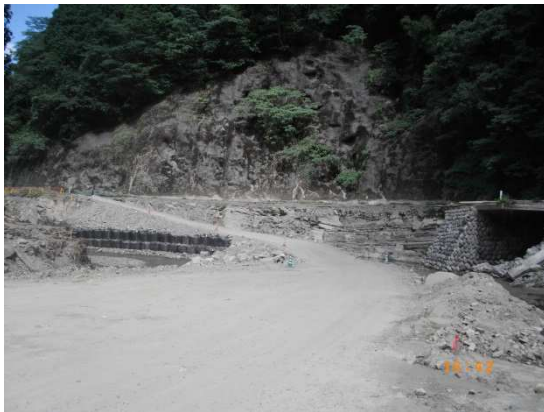
写真-3 黒川の水衝部 崩壊した県道甘木吉井線 岩盤部と上部法面崩壊せず
