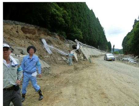
県道 588 号の崩壊状況 (写真左が道路、右が黒川、軽が通行している箇所は河川内?)
