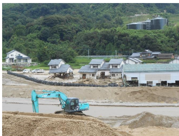
大きく地域が分断された地区（赤谷川沿い）
