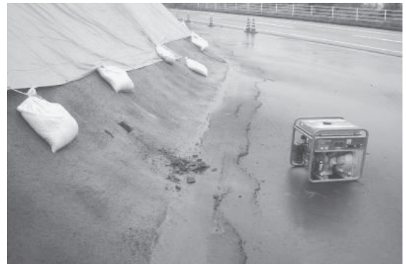
写真-1 のり尻のアスファルト舗装の盛り上がり
