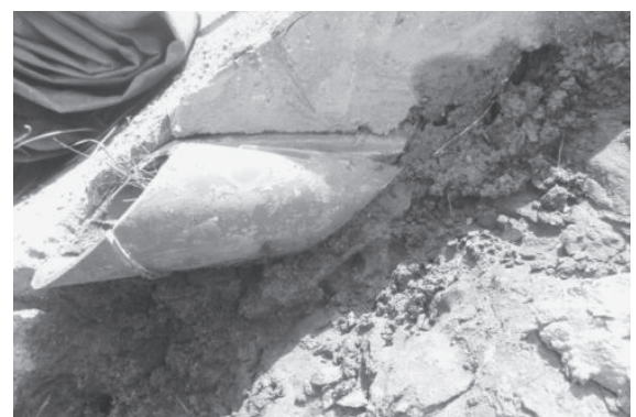
写真-2 モルタルで閉塞された水抜きパイプ
