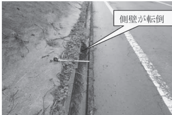
写真-3 モルタル層の押し出しで側溝側壁が転倒している。
