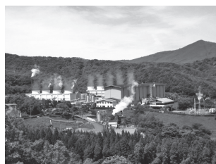
八丁原地熱発電所 提供元：(株)九州電力
